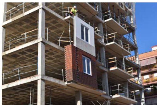
Dos paneles de fachadas industrializadas de Spans siendo colocados en un bloque de viviendas en Valencia.
